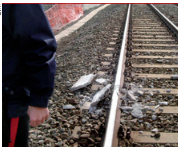
I resti dei massi di cemento trovati accanto ai binari della linea Torino-Ceres, all'altezza di Venaria.
