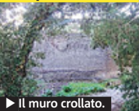
► Il muro crollato.
