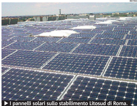
► I pannelli solari sullo stabilimento Litosud di Roma.
