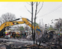
Le macerie e, sullo sfondo, la ferrovia.
