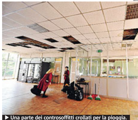
► Una parte dei controsoffitti crollati per la pioggia.
