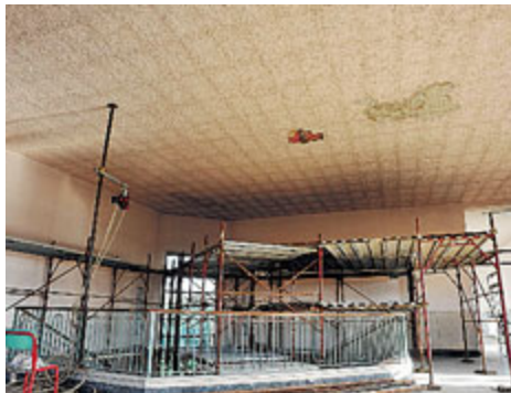
► I ponteggi per il crollo del 3 maggio. Il piano di evacuazione non sarebbe idoneo, quindi scuola resta chiusa.
