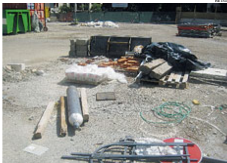
► Materiale abbandonato nel cantiere in piazza Marucchi.
