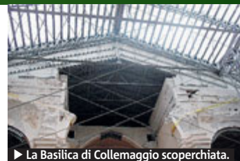
► La Basilica di Collemaggio scoperchiata.
