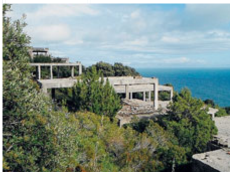
► Alcuni degli scheletri che verranno demoliti al Circeo. LEGAMBIENTE
