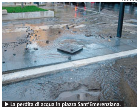
► La perdita di acqua in piazza Sant'Emerenziana.
