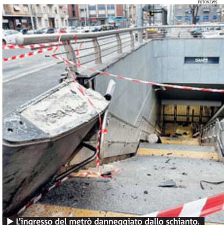
► L'ingresso del metrò danneggiato dallo schianto.
