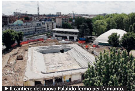
► Il cantiere del nuovo Palalido fermo per l'amianto.
