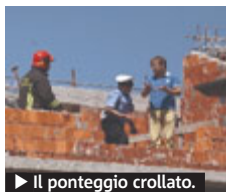
► Il ponteggio crollato.
