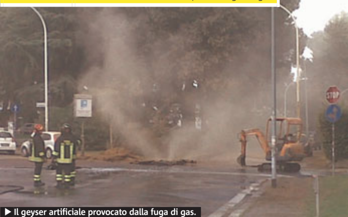
► Il geyser artificiale provocato dalla fuga di gas.
