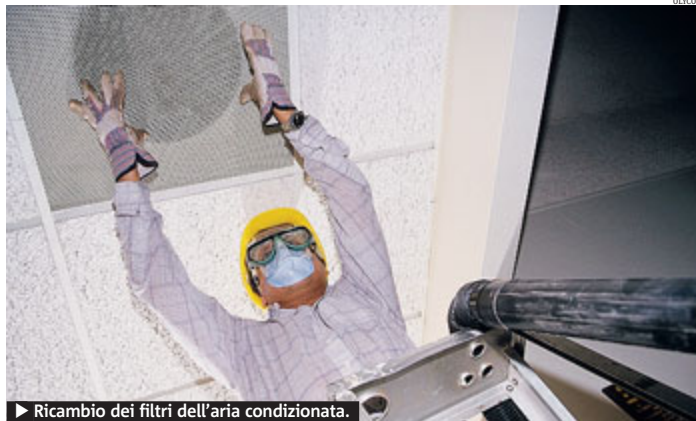
► Ricambio dei filtri dell'aria condizionata.
