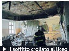
► Il soffitto crollato al liceo
