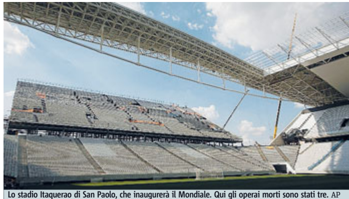
Lo stadio Itaquerao di San Paolo, che inaugurerà il Mondiale. Qui gli operai morti sono stati tre. AP
