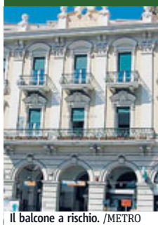
Il balcone a rischio. /METRO
