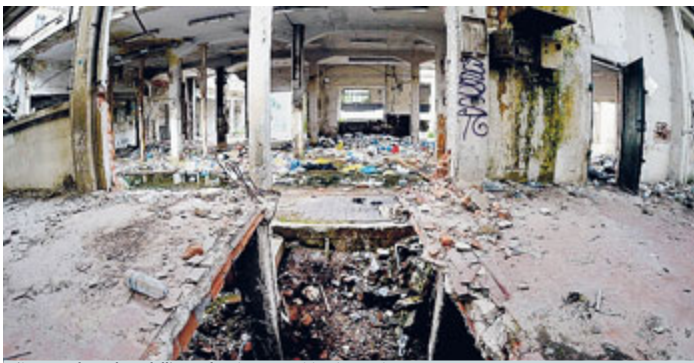
L'interno degradato dell'ex Galvanica Lorenzi in via Bazzi 12. FOTO BETTOLINI
