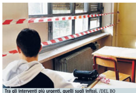
Tra gli interventi più urgenti, quelli sugli infissi. /DEL BO
