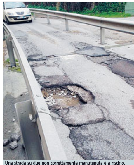
Una strada su due non correttamente mantenuta è a rischio.
