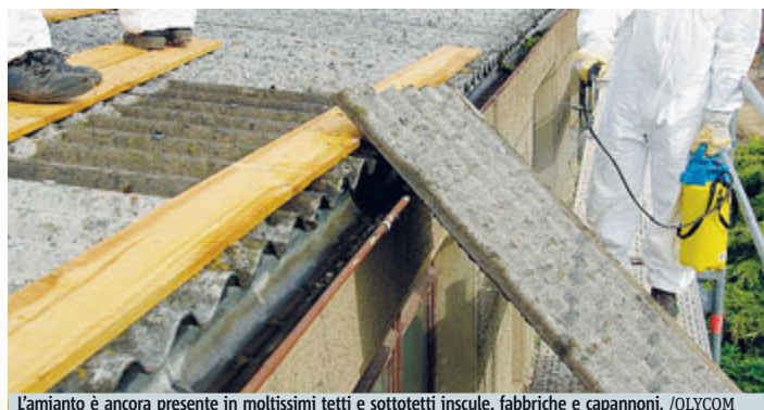
L'amianto è ancora presente in moltissimi tetti e sottotetti insule, fabbriche e capannoni. /OLYCOM
