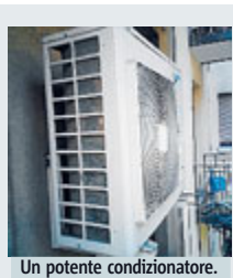
Un potente condizionatore.
