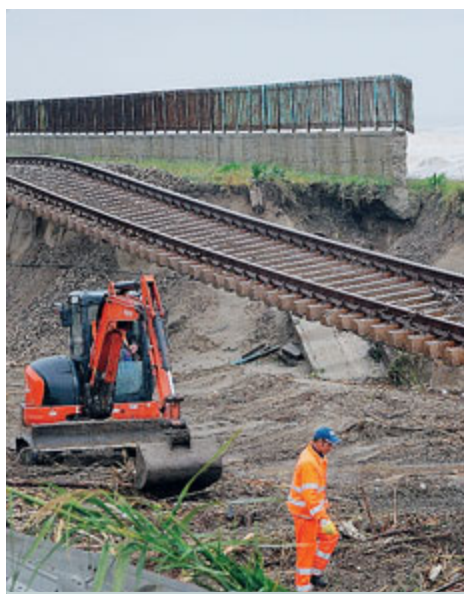
Ferrovia danneggiata a Brancaleone (Reggio Calabria). / L'ESPRESSO
