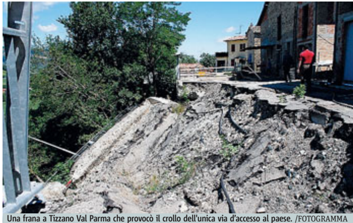
Una frana a Tizzano Val Parma che provocò il crollo dell'unica via d'accesso al paese. /FOTOGRAMMA
