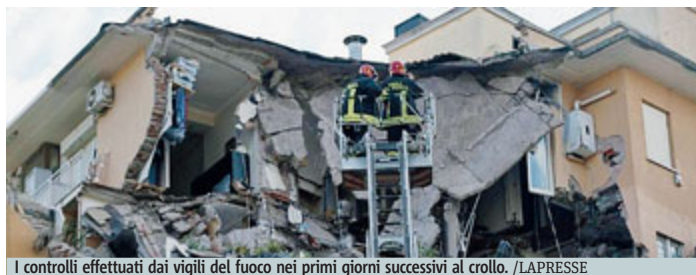
I controlli effettuati dai vigili del fuoco nei primi giorni successivi al crollo. /LAPRESSE
