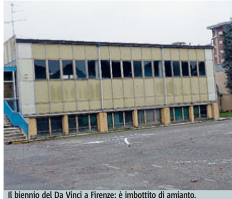
Il biennio del Da Vinci a Firenze: è imbottito di amianto.
