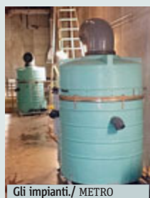
Gli impianti. / METRO
