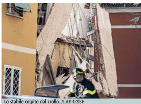
Lo stabile colpito dal crollo. / LAPRESSE
