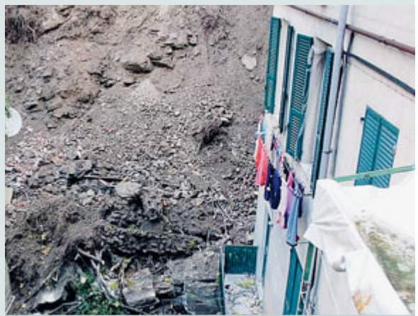
La frana che minaccia alcuni palazzi sulle colline di Genova. /GENOVA TODAY
