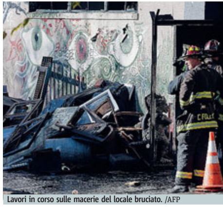
Lavori in corso sulle macerie del locale bruciato. /AFP
