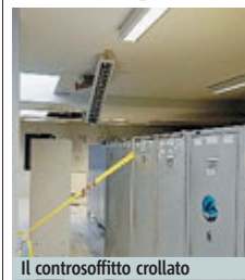
Il controsoffitto crollato
