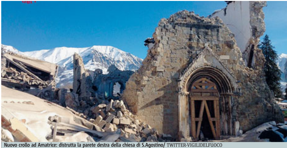
Nuovo crollo ad Amatrice: distrutta la parete destra della chiesa di S. Agostino/ TWITTER-VIGILIDELFUOCO
