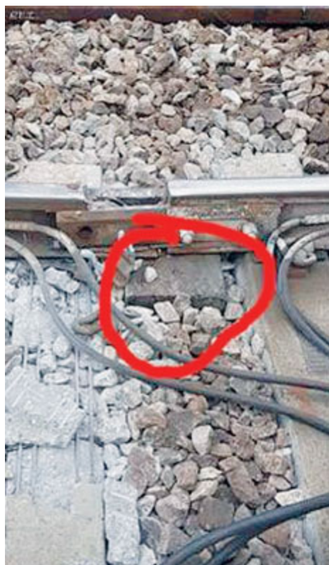
Il giunto rotto sul binario. Sotto è visibile il tassello di legno utilizzato per le eventuali sostituzioni. METRO
