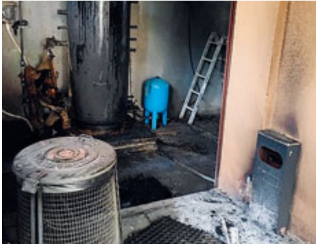
Il locale della palestra colpito dall'incendio/ AGENZIANOVA
