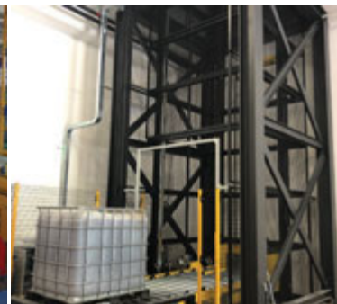
ELEVATORE IDRAULICO AD ALTA VELOCITÀ (2)
