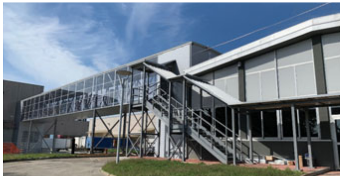
TUNNEL SOPEPO PER TRASPORTO PALLET
