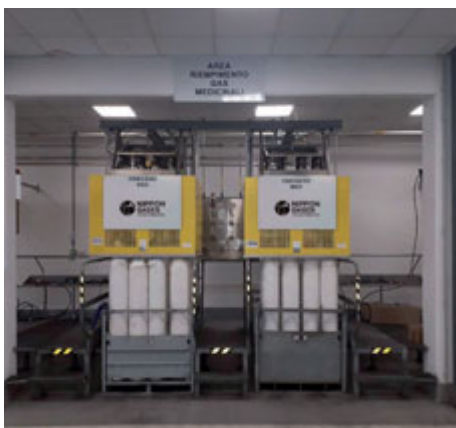
AREA RIEMPIMENTO GAS MEDICINALI DELLA NIPPON GASES ITALIA
